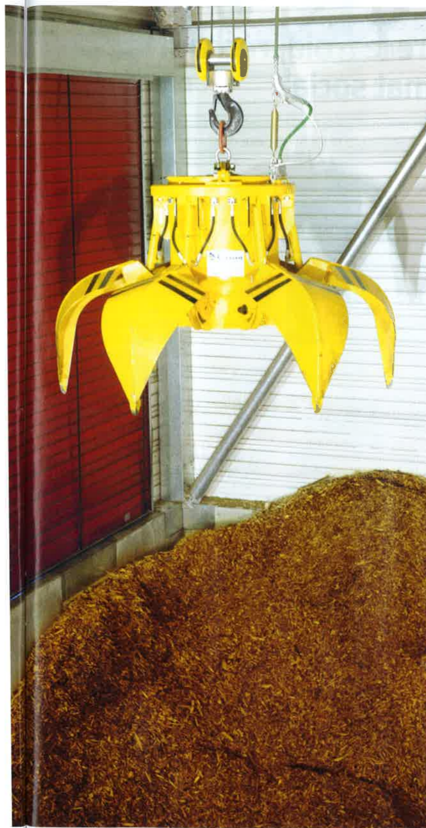
La chaufferie de SKF consomme 3 800 tonnes de résidus de bois par an.
